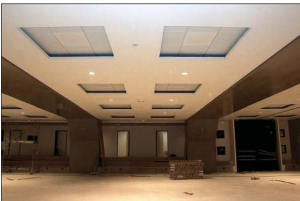
Приборы неплохо вписываются и в восточный стиль. На этом снимке они обогревают зал фехтования на мечях дзюдо-центра в Париже.
